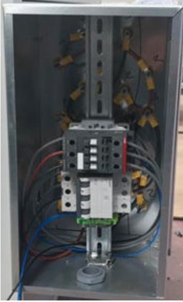
Resim 2 : IGK Elektrik Bağlantısı
